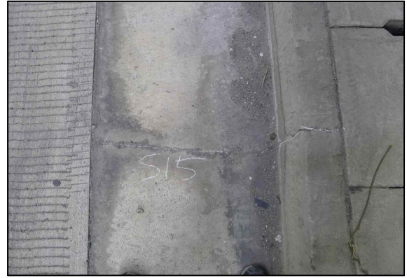
b. 측구 S15 균열(0.3mm미만)
