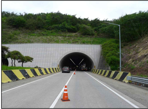
a. 시점부 갯문 상태양호
