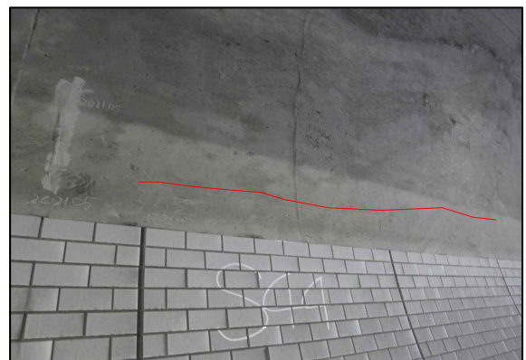
h. 측벽부 S44 우측 균열(0.3mm미만)
