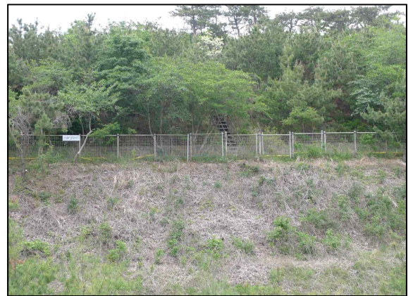
d. 사면 내 점검계단 및 웬스 설치현황
