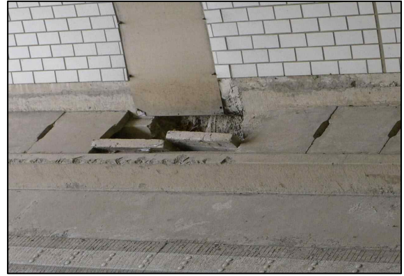
b. 공동구 S1 좌측 덮개 파손
