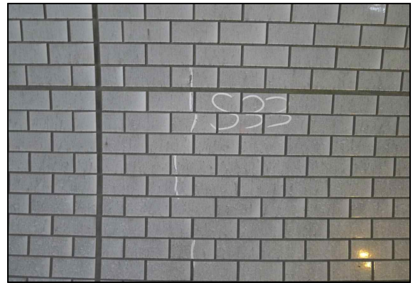
f. 측벽부 S33 좌측 타일 균열
