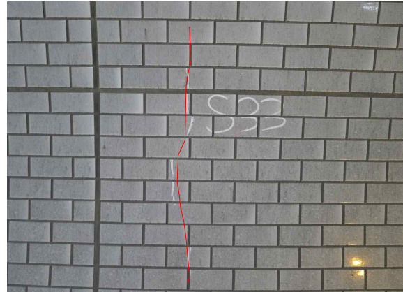
b. 측벽부 S33 횡균열(타일부 반사균열) 발생 현황
