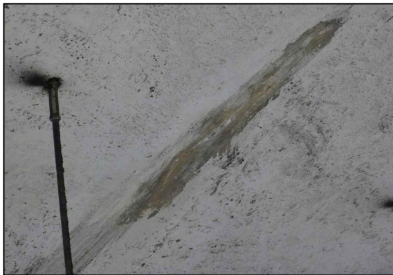
g. 천단부 S32 균열부백태(0.3mm미만)
