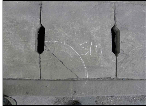
b. 공동구 S17 우측 덮개 파손
