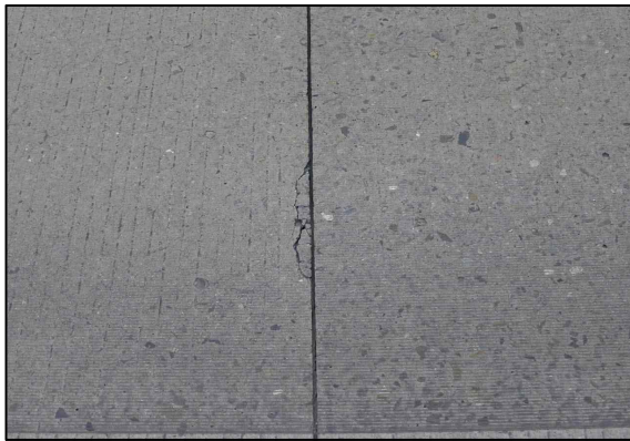
e. 포장부 S21 줄눈 주변 파손
