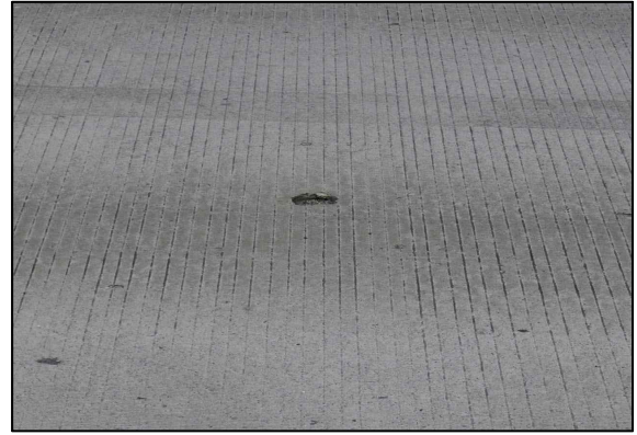
d. 포장부 S19 파손
