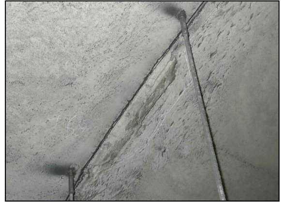
l. 천단부 S68(J68) 시공이음부 박락
