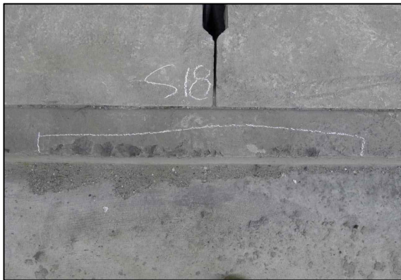
e. 공동구 S18 우측 파손
