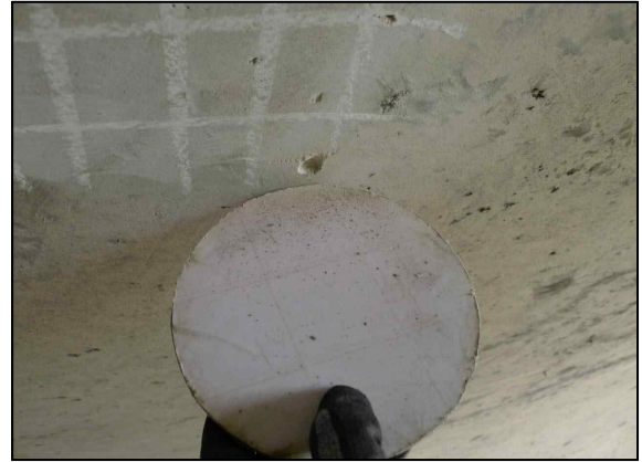
b. 탄산시험부 변색유무 확인
