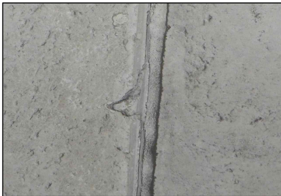
i. 천단부 S38(J38) 시공이음부 박락
