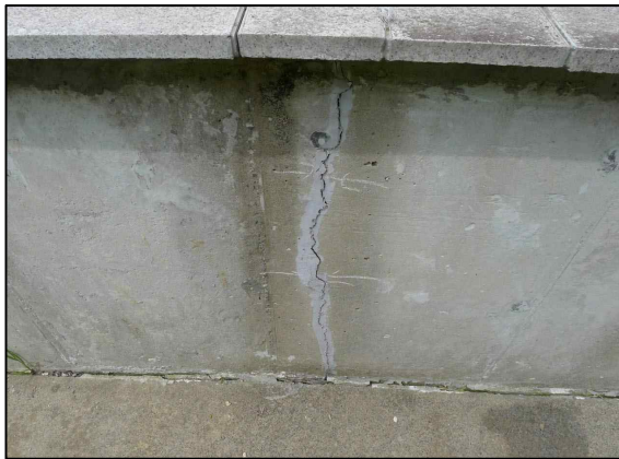
a. 시점 도수로 재균열(0.3mm이상)
