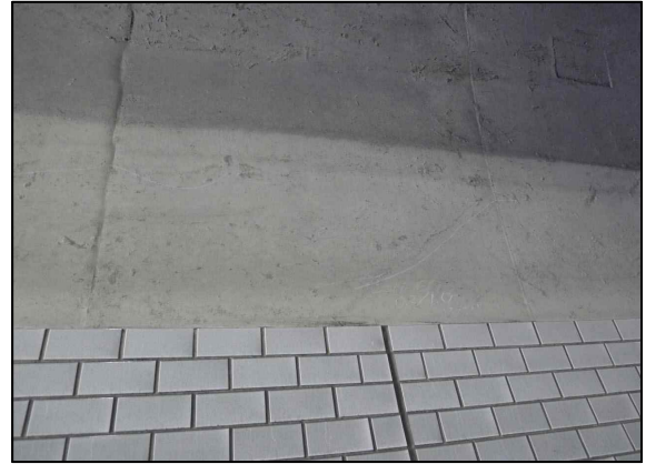
l. 측벽부 S70 우측 균열(0.3mm 미만)
