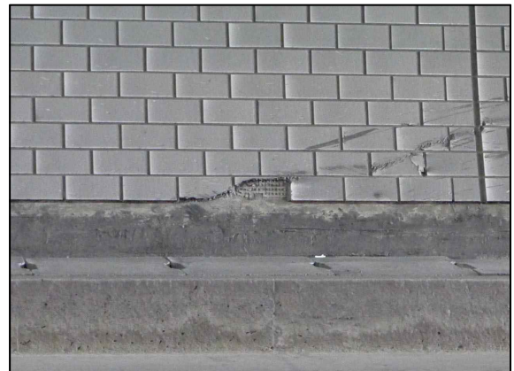
n. 측벽부 S71 좌측 타일 탈락, 파손
