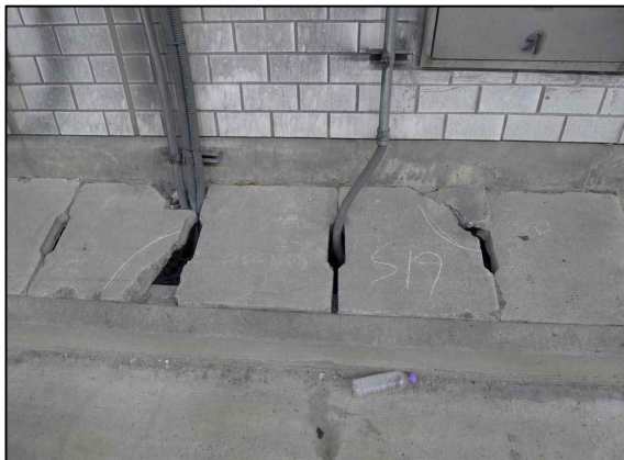
c. 공동구 S19 우측 덮개 파손
