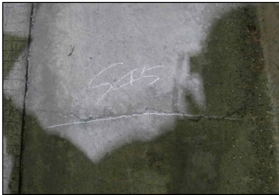
c. 측구 S45 균열(0.3mm미만)
