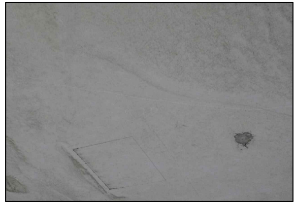
f. 천단부 S20 균열(0.3mm미만)
