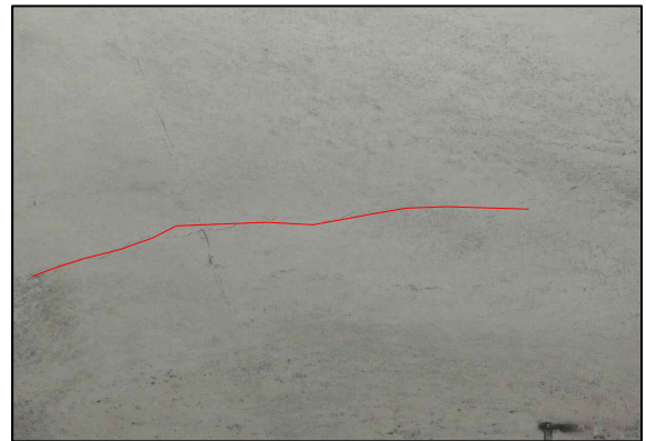
h. 천단부 S34 균열(0.3mm 이상)
