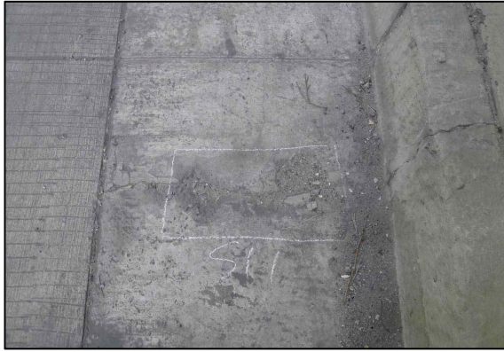
a. 측구 S11 파손
