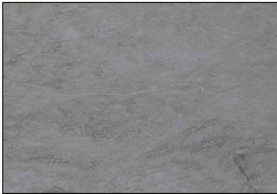
e. 천단부 S12 균열(0.3mm미만)
