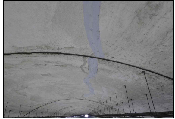
d. 천단부 S11 균열 보수현황
