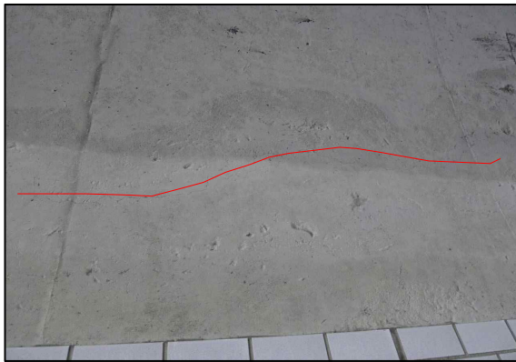
e. 측벽부 S23 우측 균열(0.3mm미만)
