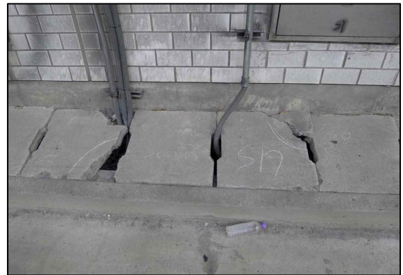
f. 공동구 S19 우측 덮개 파손
