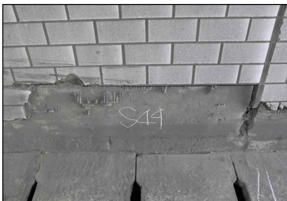
i. 측벽부 S49 우측 타일 탈락
