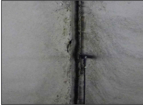
k. 천단부 S67(J67) 시공이음부 박락
