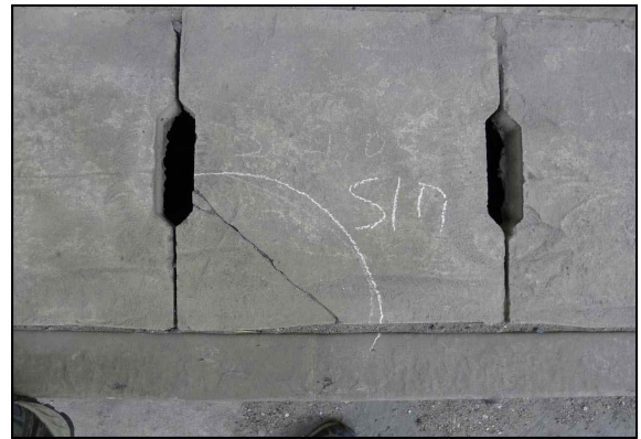
d. 공동구 S17 우측 덮개 파손
