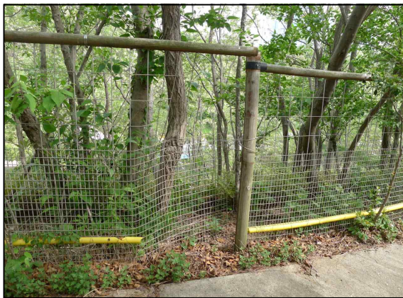
a. 종점부 웬스 파손
