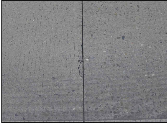
a. 포장부 S21 줄눈 주변 파손
