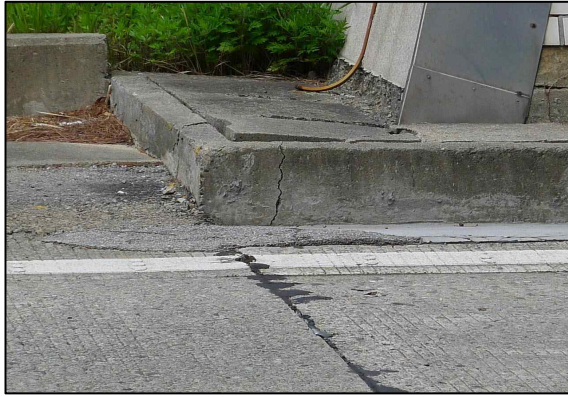
a. 공동구 S1 측면 균열(0.3mm이상)
