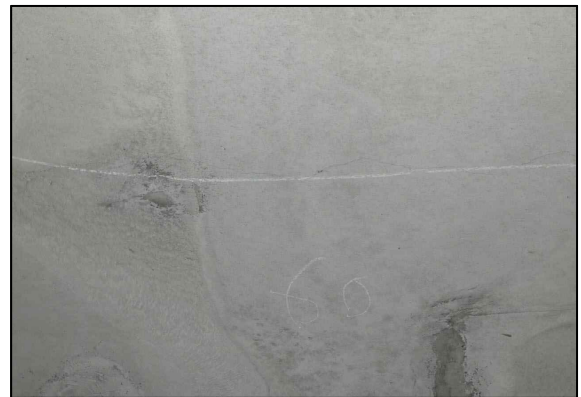
j. 천단부 S60 균열(0.3mm미만)
