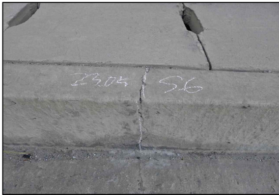
c. 공동구 S6 측면 균열(0.3mm미만)
