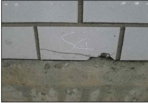
c. 측벽부 S4 우측 타일탈락, 파손
