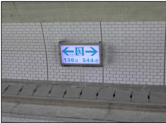
a. 비상구 표시등 설치현황
