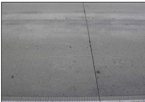
g. 포장부 S28 균열
