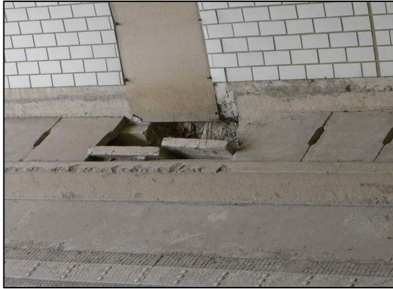
a. 공동구 S2 좌측 덮개 파손
